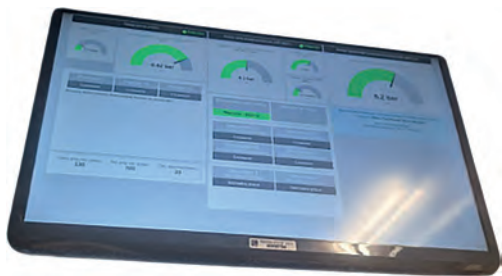
Rys. 5. Wyświetlacz prezentujący odczyty z systemu monitoringu instalacji gazów medycznych Fig. 5. Display presenting readings from the medical gas installation monitoring system
